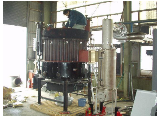
試験設備での燃焼試験中のトモエ蒸気ボイラ
